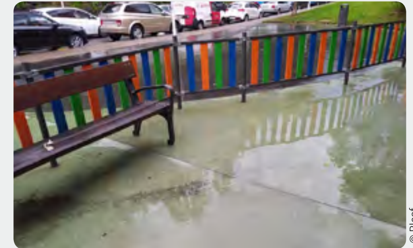
Detalle de agua embalsada sobre suelo de baldosa impermeable.
